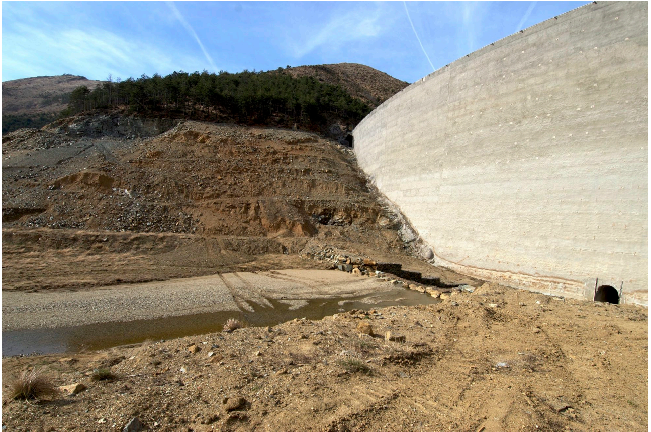
Figura 2. Vista a monte del corpo diga: la freccia indica la gabbionata posta a salvaguardia da interrimento del cunicolo di ispezione.
