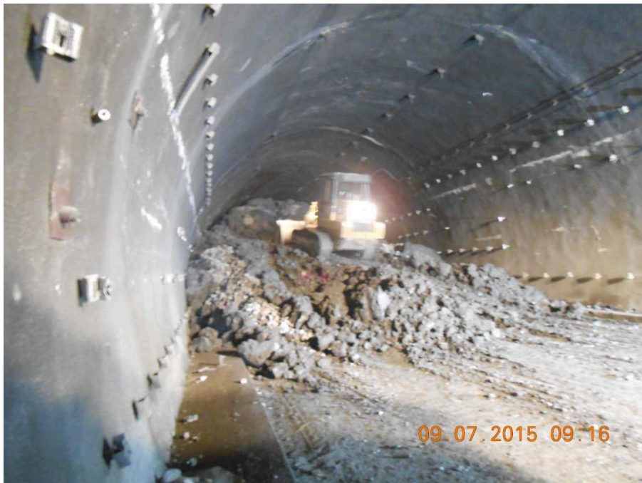
Figura 1: Ritombamento vecchia galleria Serra Rotonda – area critica 1
