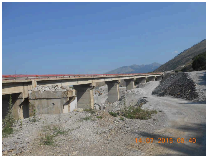
Figura 8: Viadotto Pianicelli 1 carr. nord – area critica 3
