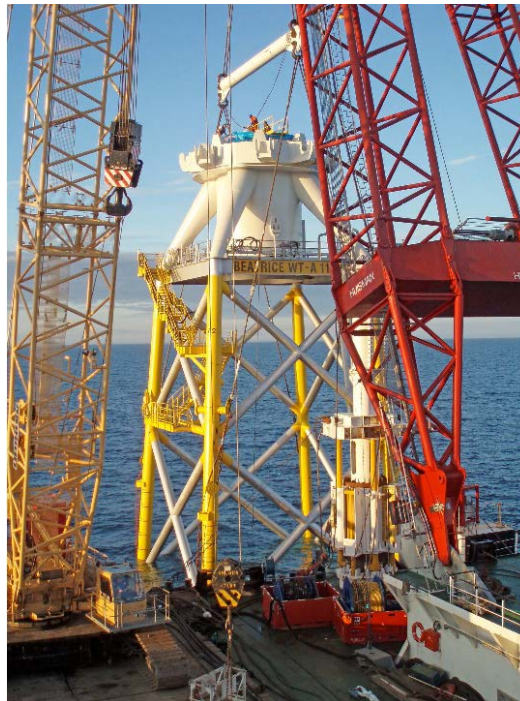
Fig. 2-15 Fondazione a castello a quattro montanti per turbina eolica 5M, mentre si sta predisponendo lo zoccolo di base della torre (REpower)
