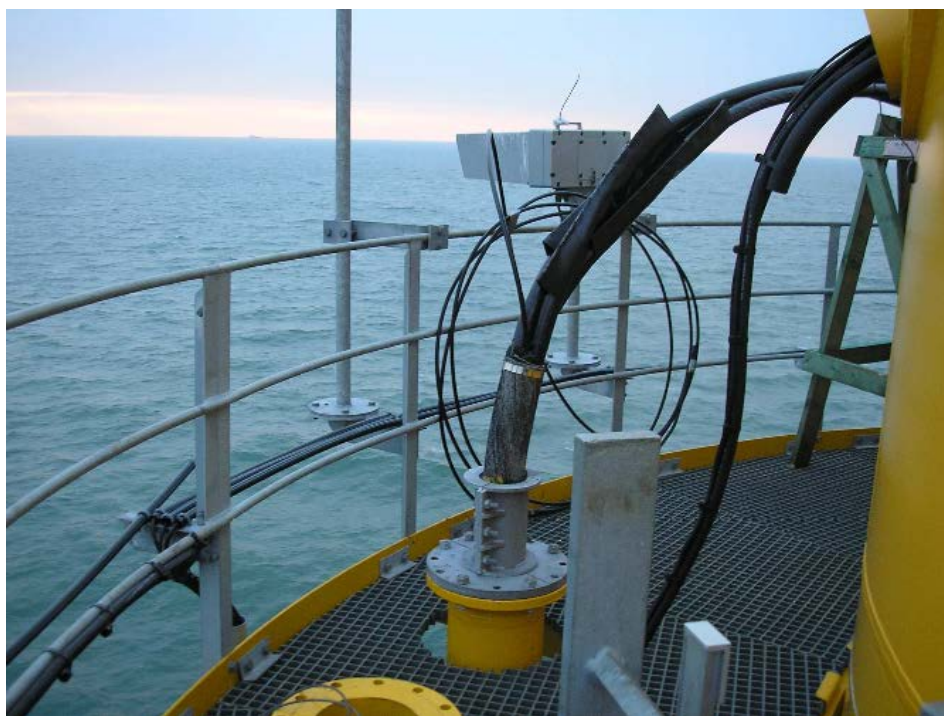
Fig. 2-25 Uscita dei cavi dal tubo di guida e connessioni con i quadri all'interno dell'aerogeneratore
