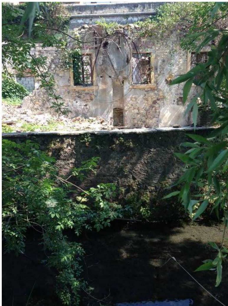
Foto 7 – “Mulino”: panoramica e sezione in uscita nello “scolo Orti”
