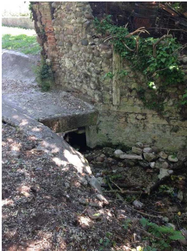
Foto 3 – “Fontanella delle monache”: canalizzazione in uscita dalla vasca verso il vicino “scolo Orti”
