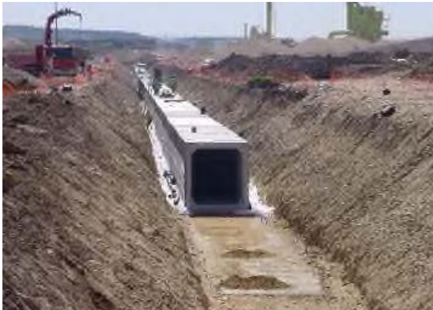
Figura 2-3- Realizzazione di galleria in cui alloggiare cavo a 380 kV sotto aeroporto di Barajas a Madrid
