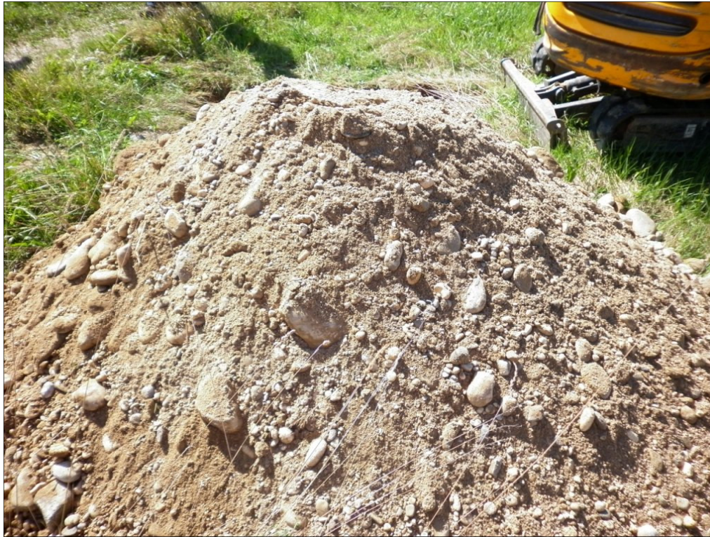
Figura 9.2: cumulo di materiale escavato durante le operazioni di prelievo dei campioni di terreno sui cui eseguire le analisi chimiche.
