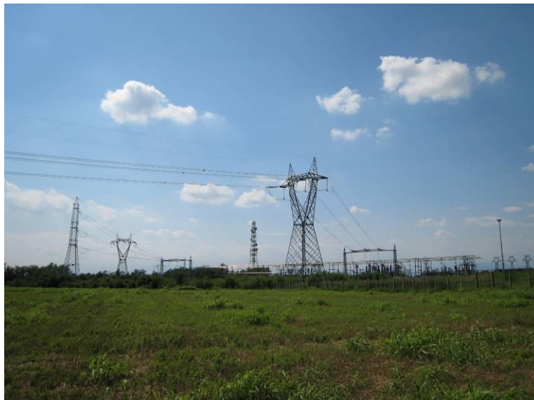
Foto 3-2: Visuale da Nord, dello stato attuale della stazione elettrica di Udine Ovest
