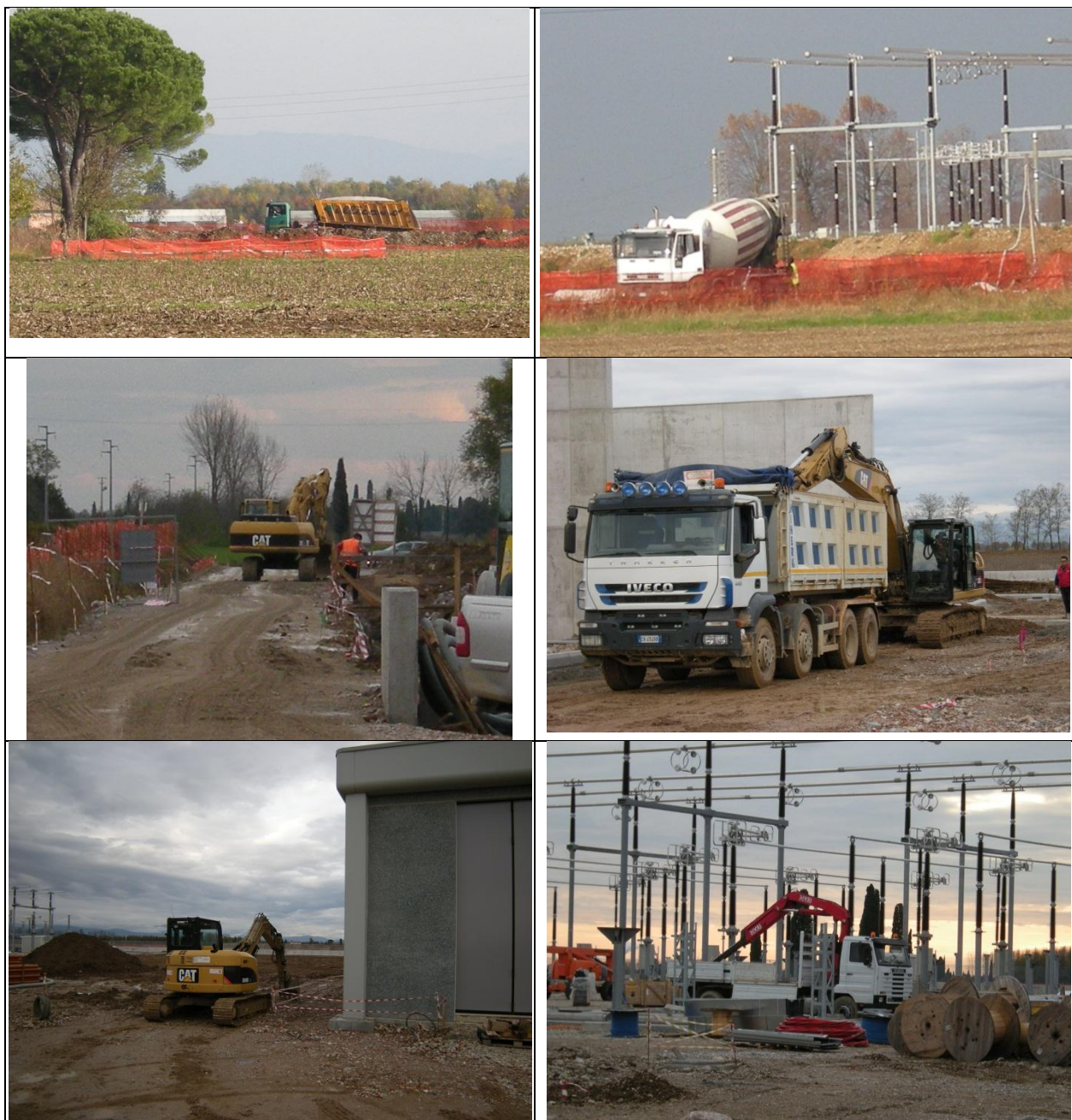
Figura 3 – S.E. di Udine Sud: campagna n° 8 di Nov 2014 - Immagini fotografiche delle lavorazioni in corso presso il cantiere
