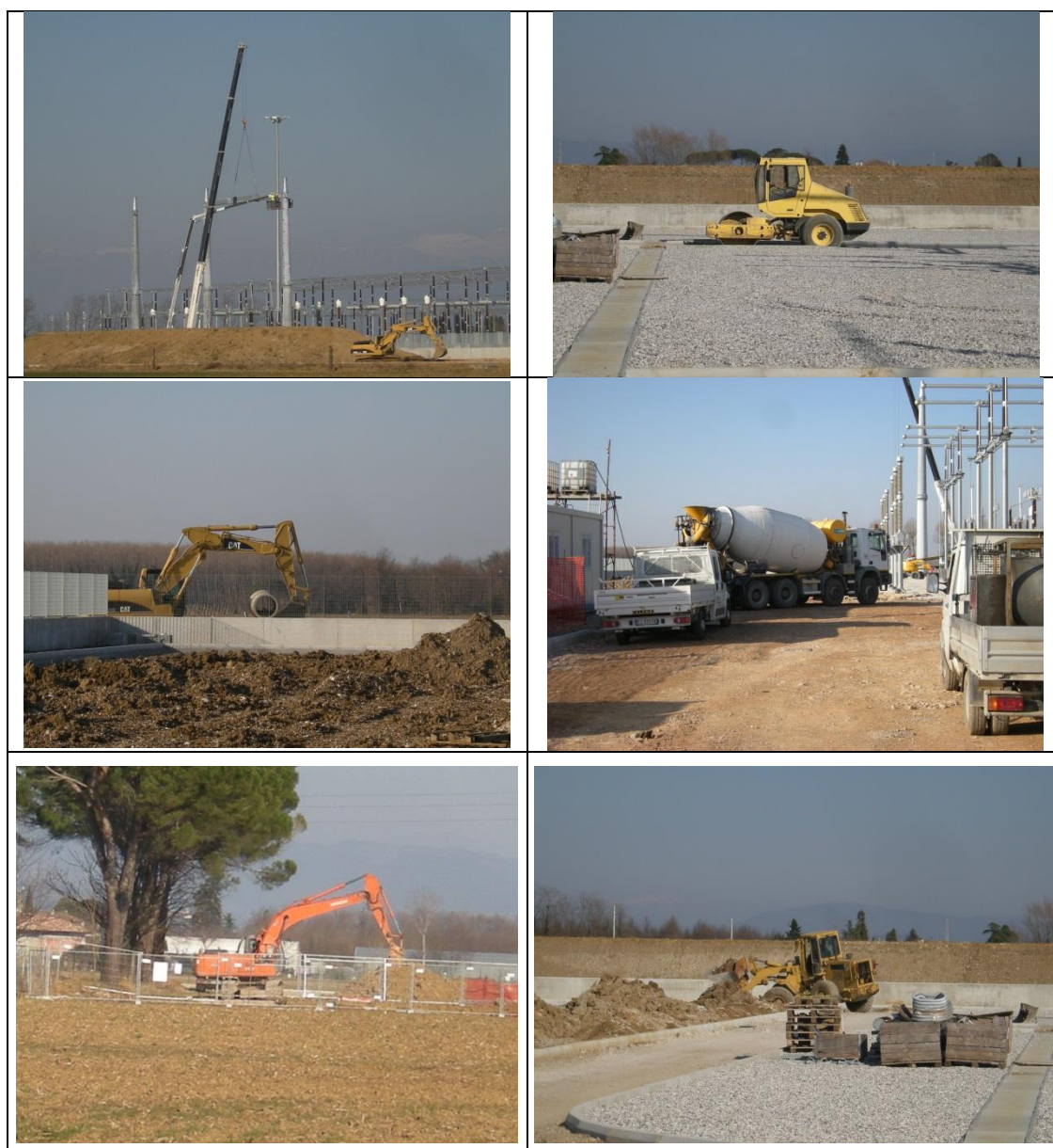
Figura 4 – S.E. di Udine Sud: campagna n° 10 - Corso d’opera Febbraio 2015 - Immagini fotografiche delle lavorazioni in corso presso il cantiere
