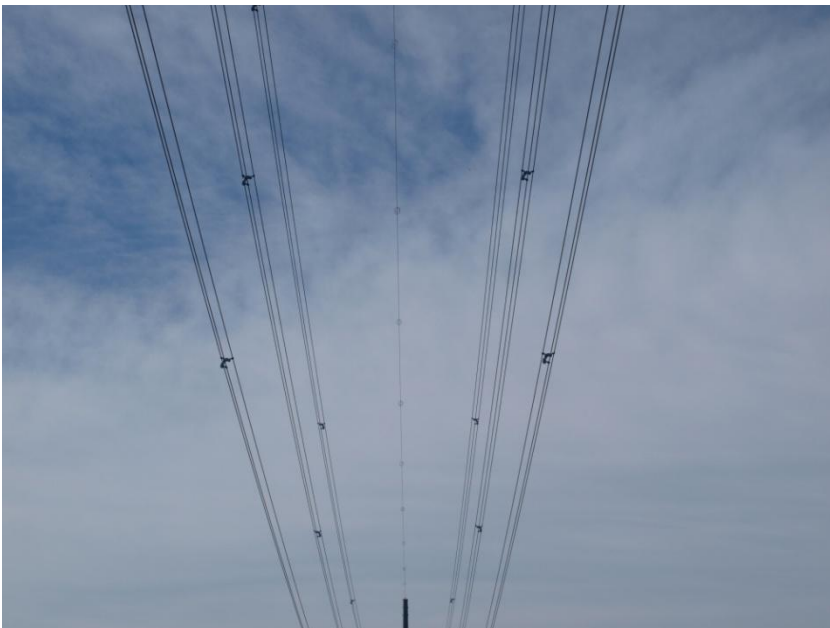
Foto 6 - Recenti installazioni di spirali di segnalazione per avifauna (linea Trino – Lacchiarella loc. Bereguardo) - Visione d'insieme
