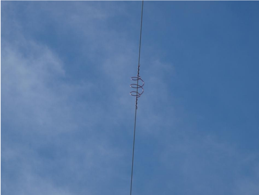
Foto 5 - Recenti installazioni di spirali di segnalazione per avifauna (linea Trino – Lacchiarella loc. Bereguardo) - Particolare
