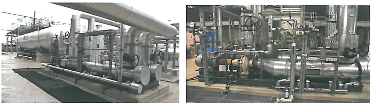
Fig. 17 - 18 - Elementi dell' impianto di produzione installati all'aperto
