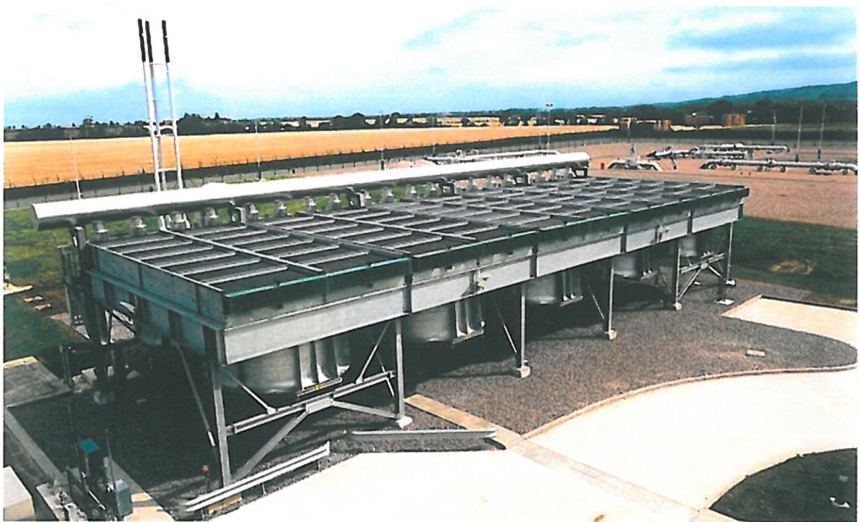
Fig. 16 - Esempio di condensatore con gruppo chillers a fasci tubieri
