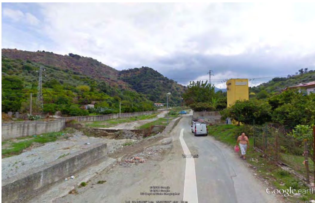
Gualtieri Sicaminò (ME): 38.158465°, 15.317301° - strada urbana (lato Santa Lucia del Mela) lungo la fumara Gualtieri con interruzione del muro d'argine (sponda sinistra)
