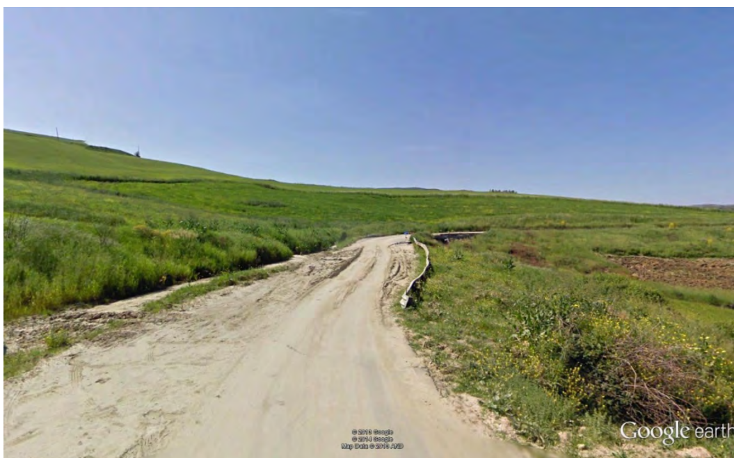
Piazza Armerina (EN): 37.480397°, 14.309200° - effetti di cattiva regimazione di acque torrentizie sulla vecchia SS117bis
