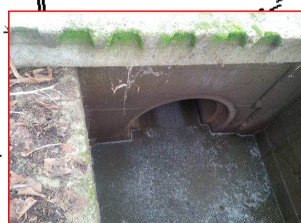
Pozzetto di ispezione della tombinatura presso località Caselle (tubazione in ingresso)
