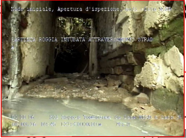
Ingresso della tombinatura sottostante la sede stradale da nord verso sud (immagine da videospesione)
