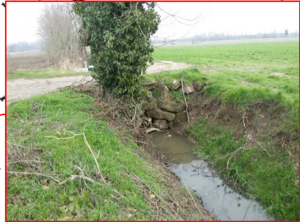
Manufatto di attraversamento con sezione ostruita
