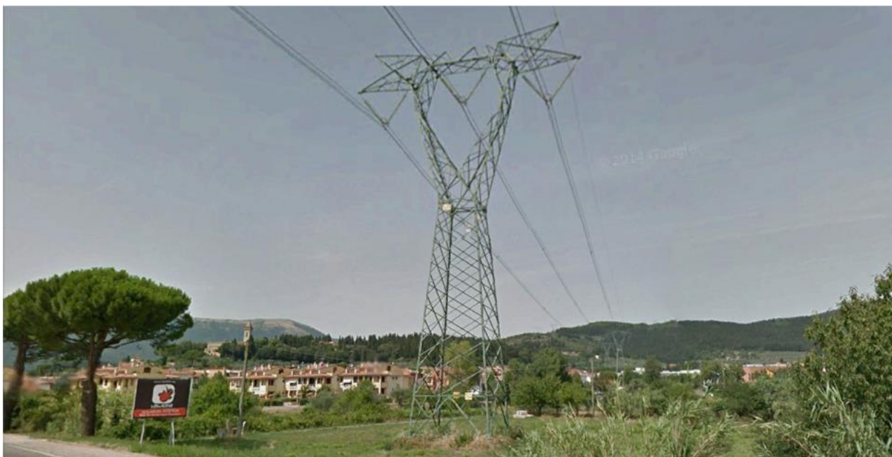
Foto f - Vista da via Giusti verso nord. In questo tratto la linea a 380 kV Bargi-Calenzano esistente sarà demolita mentre la nuova linea seguirà l'andamento del torrente Chiosina-Garille, a destra nella foto.
