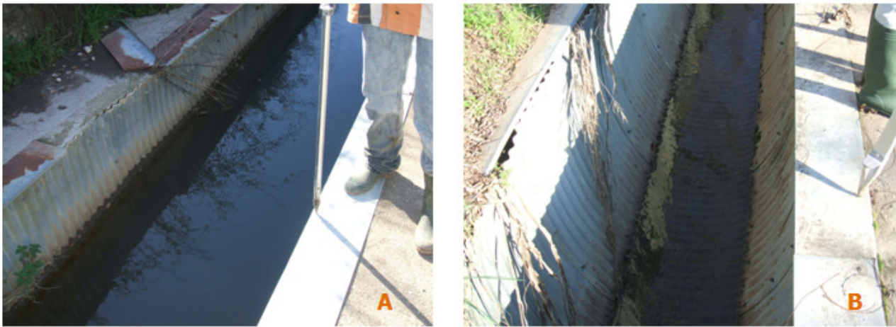
Figura 11-4 Sezione attuale del Torrente Volta Ladri (A) e del Torrente Diavolone (B)
