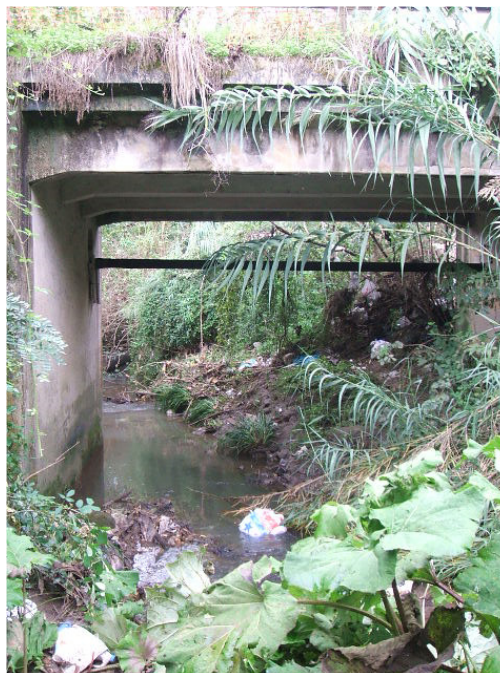
Figura 11-3 Le condizioni del corso d'acqua in corrispondenza del ponte di Via Lago Carezza
