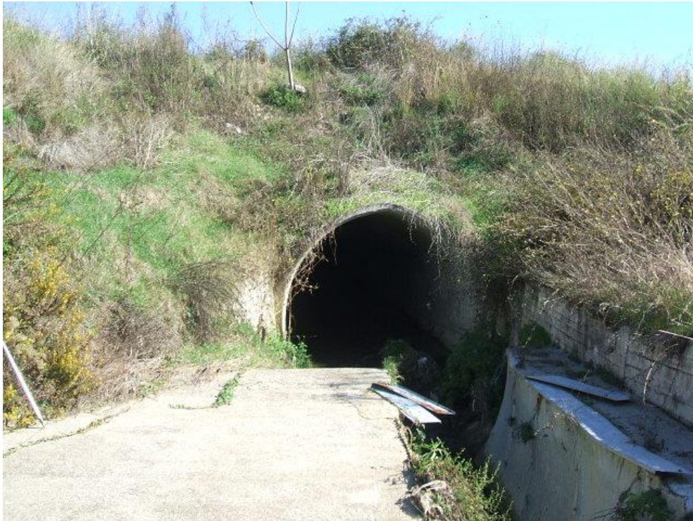
Fig. SF1.2.4: Tombinatura del Torrente Volta Ladri.
