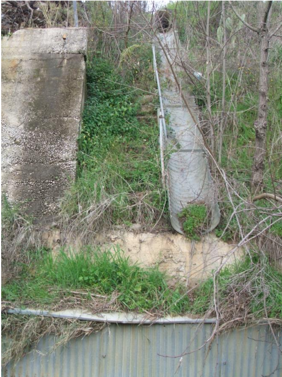
Fig. SF1.2.7: Particolare di uno degli scarichi.
