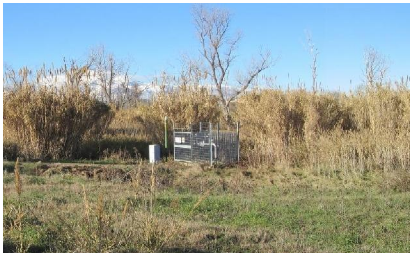
Foto 3.2.26 – Tipologico impianto di linea (PIL)
