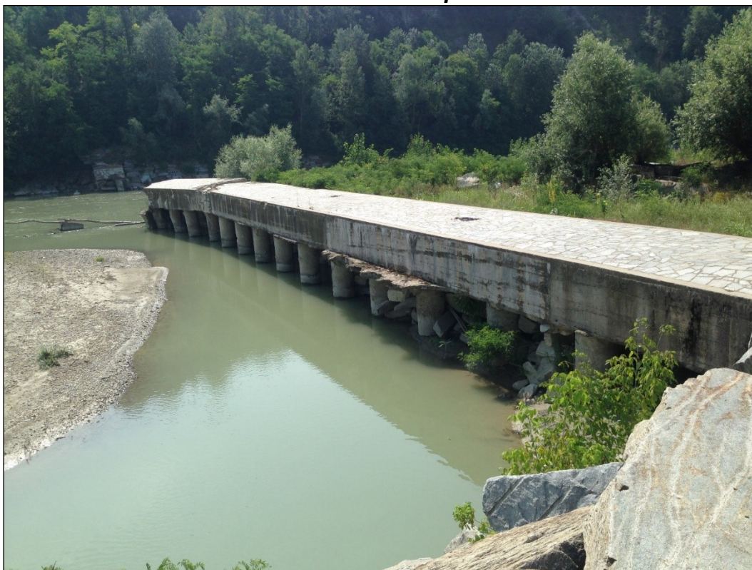
Fotografia rappresentativa della situazione attuale con la traversa in parte crollata.
