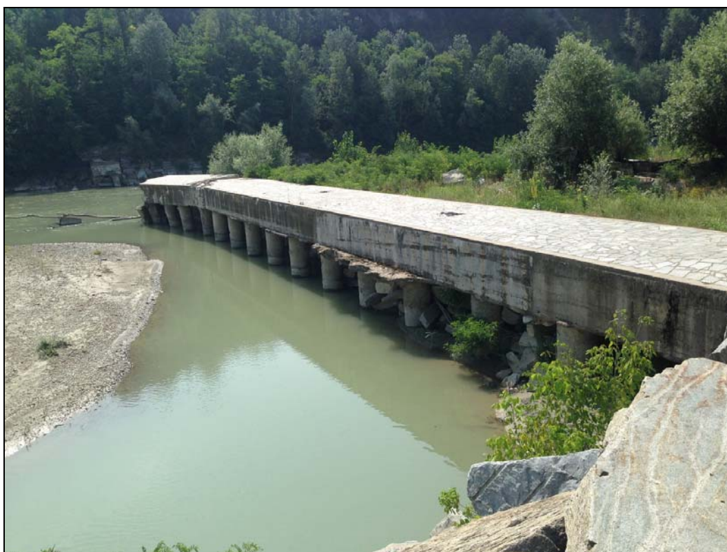
Fig. 15.f.5. Fotografia rappresentativa della situazione attuale con la traversa in parte crollata.
