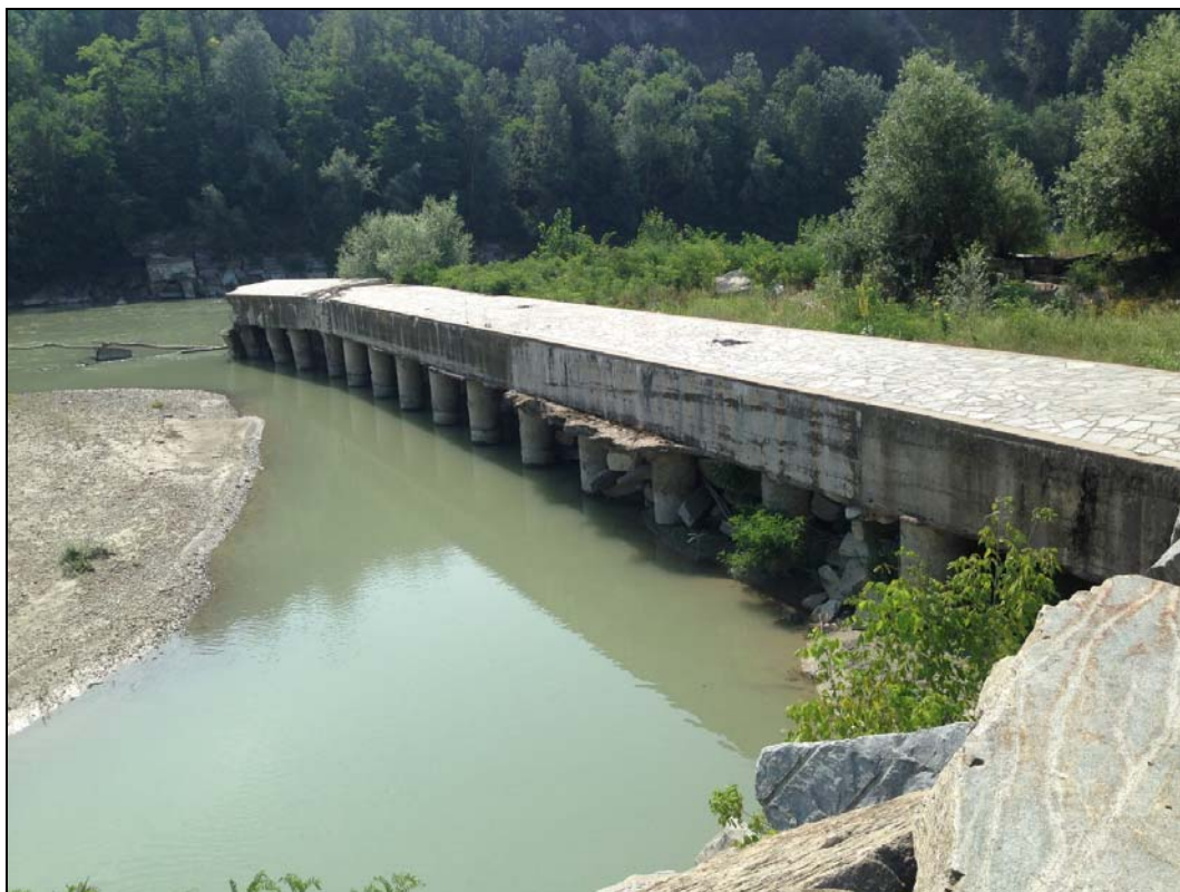
Fig. 2.b.1. Fotografia rappresentativa della situazione attuale. Si evidenzia, sulla porzione rimasta della traversa, la presenza dei pali di fondazione collegati in sommità.
