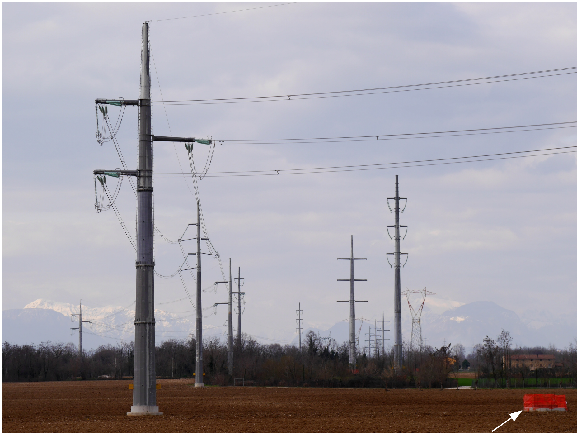
Foto 1 Comune di Basiliano linee elettriche a 380 kV affiancate (ad oggi manca l'installazione del sostegno n. 16)
