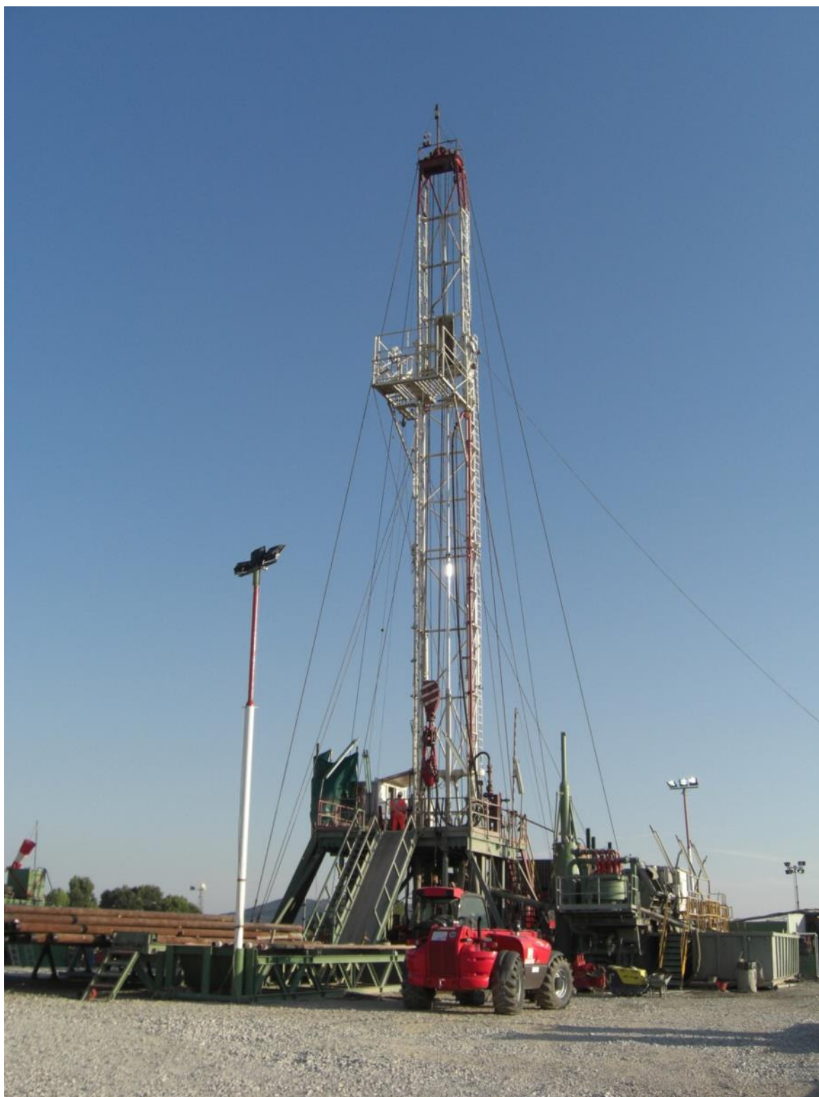
Figura C7.1: Postazione con impianto assemblato (luglio 2010, vista da Sud-Est)
