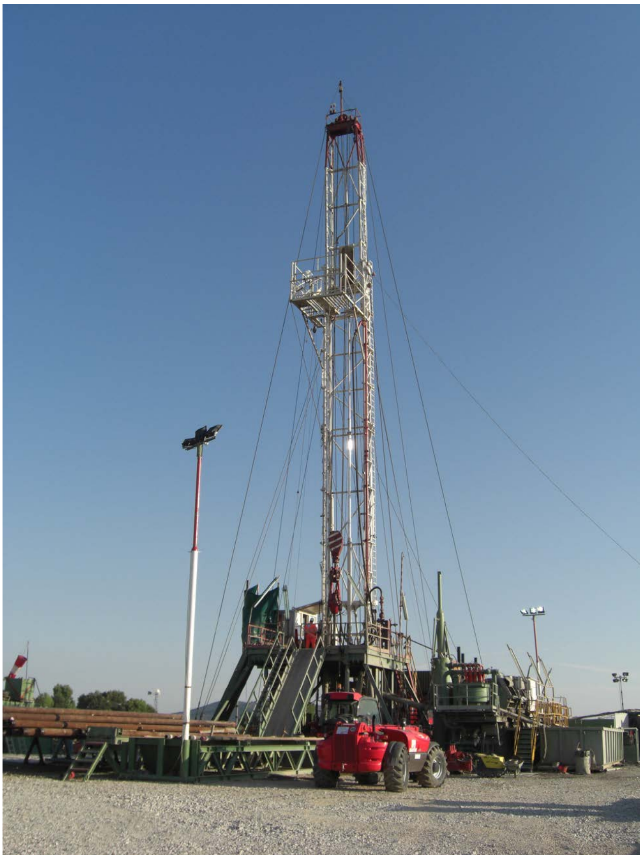
Fig. 1-A Postazione con impianto assemblato (luglio 2010)
