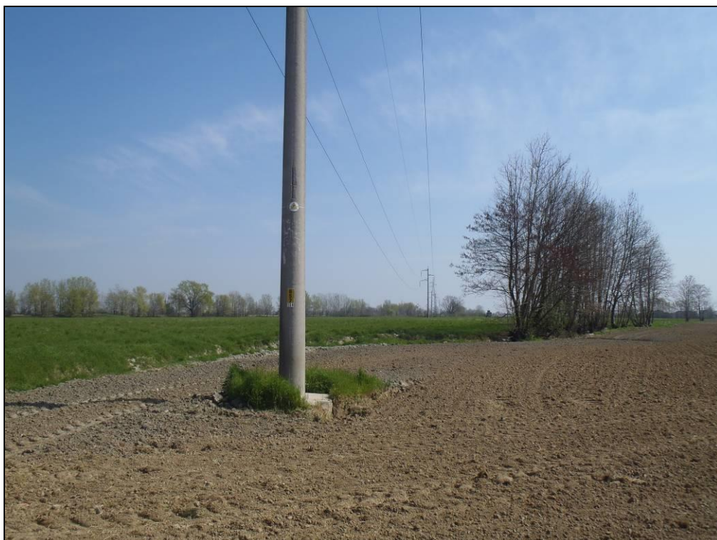
Campo nei pressi del sostegno 194.
