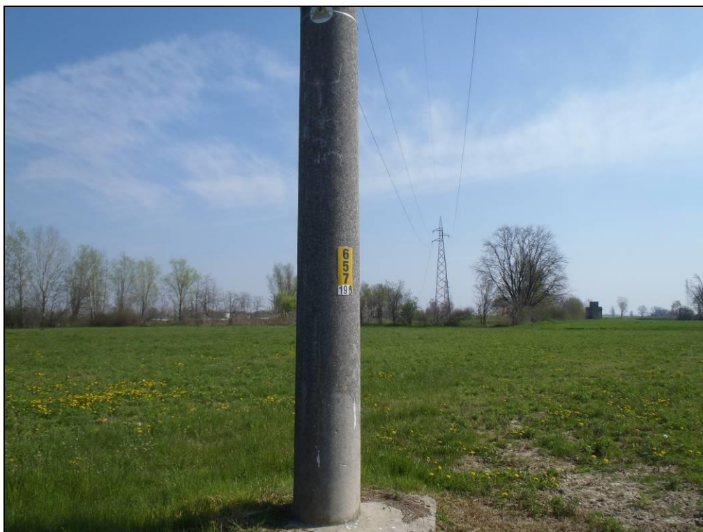
Campo nei pressi del sostegno 196.
