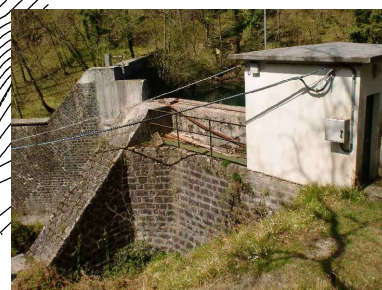
05. Contrafforti diga e locale comando paratoie scarico fondo visti dalla sponda sinistra verso destra
