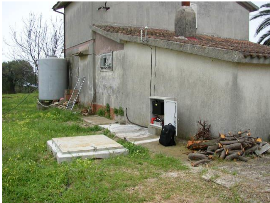
Fig. 33: armadietto con la strumentazione installato sul retro di un garage e pozzetto del sensore.
