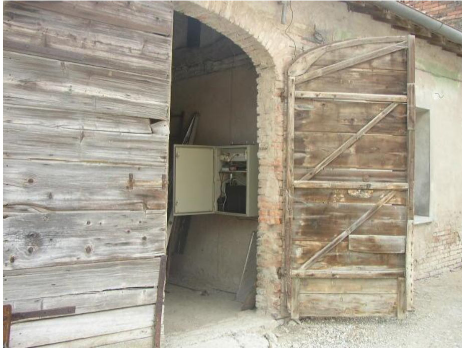
Fig. 32: armadietto con la strumentazione installato all'interno di deposito per attrezzi agricoli.
