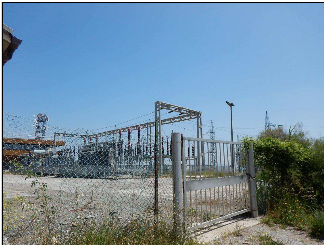
Fotografia 61 Centrale Elettrica di Piancastagnaio
