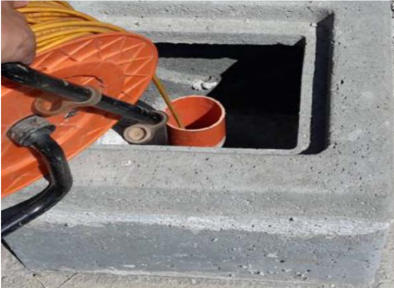
Figura 8: Misurazioni all'interno del piezometro 0
