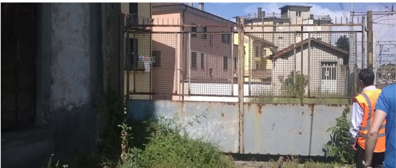
Foto 12 – Particolare del cancello.
