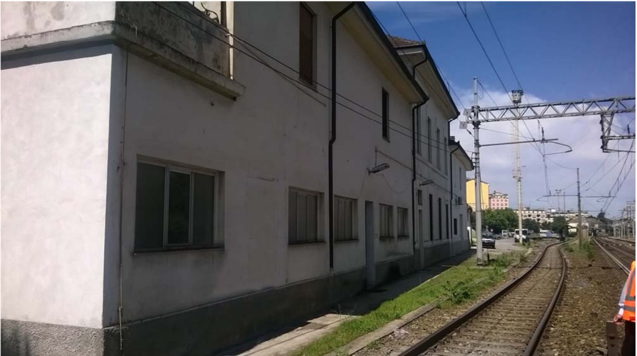
Foto 23 – L'edificio ferroviario. Si nota la carenza di spazio per l'inserimento delle barriere.
