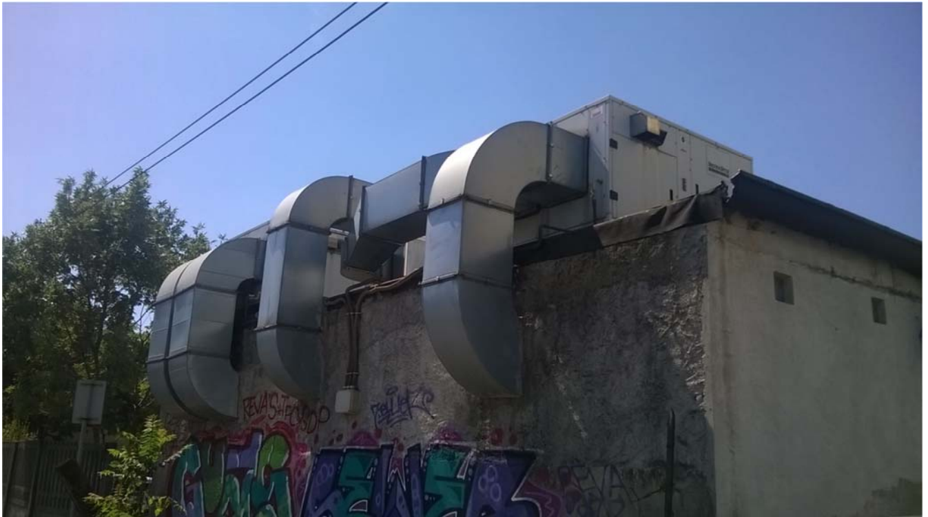
Foto 7 – Particolare dell'impianto UTA collocato sulla copertura dell'edificio.
