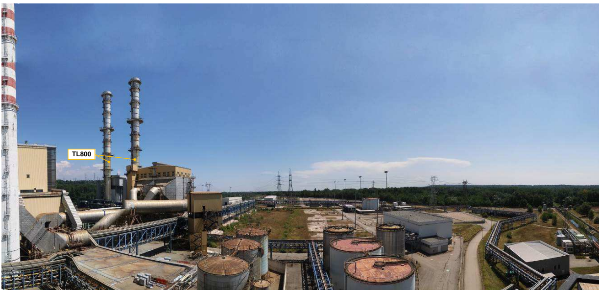
3b: Situazione della Centrale senza la realizzazione della Fase II (stato attuale).
