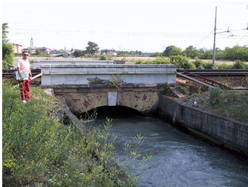
Figura 41 – Attraversamento Canale San Giovanni – Punto di presa posto a Nord-Est del manufatto, lungo la sponda sx
