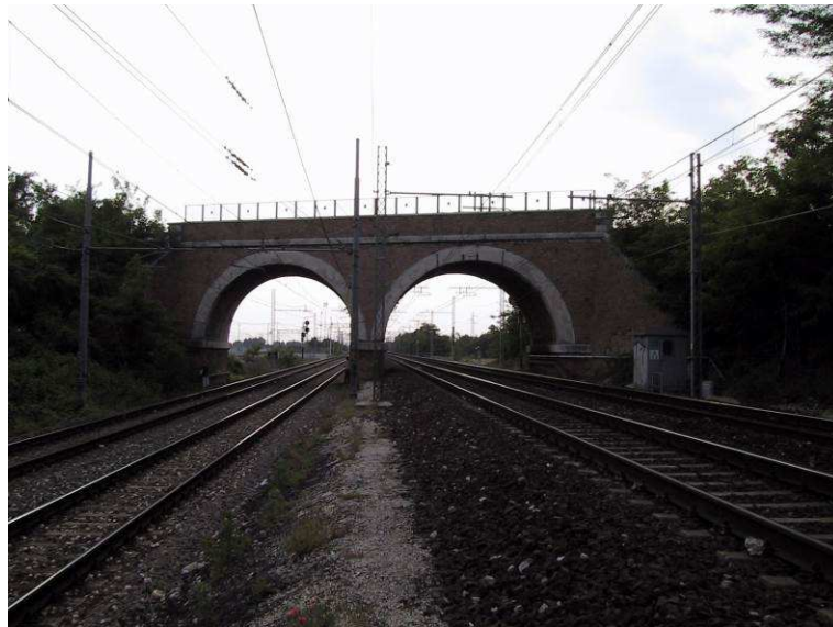
Figura 32 – Ponte a due archi in muratura, attraversamento attuale delle linee ferroviarie da parte di Via Fenilon – Punto di presa posto a Est del manufatto lungo la linea
