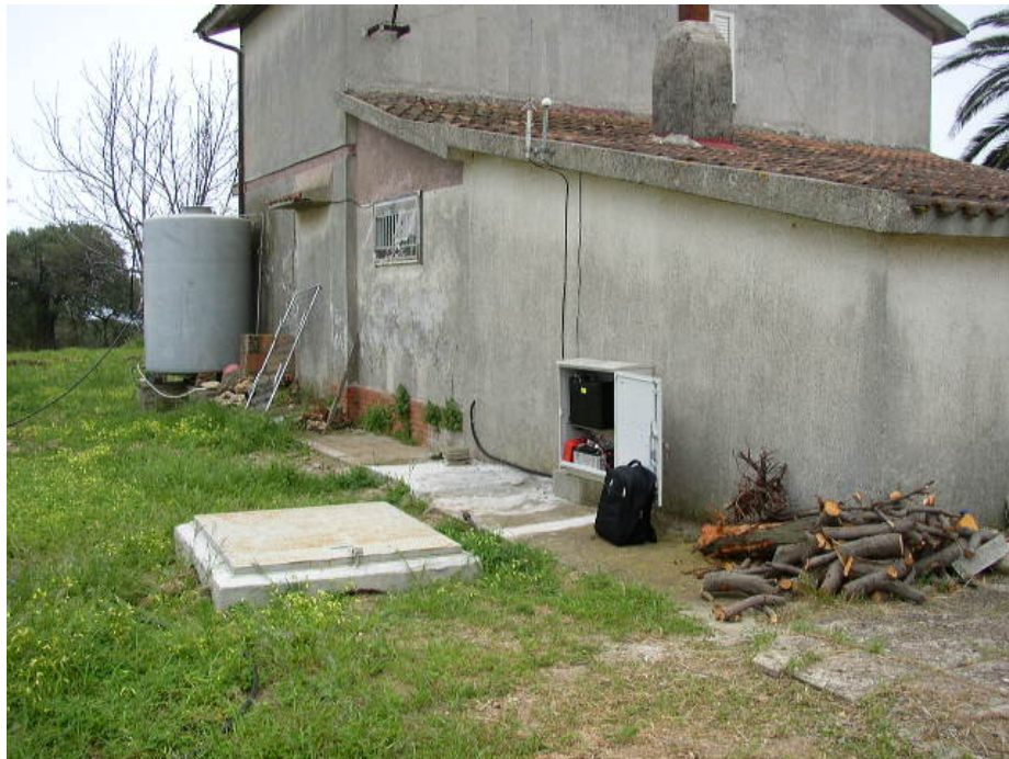
Fig. 26: armadietto con la strumentazione installato sul retro di un garage e pozzetto del sensore.
