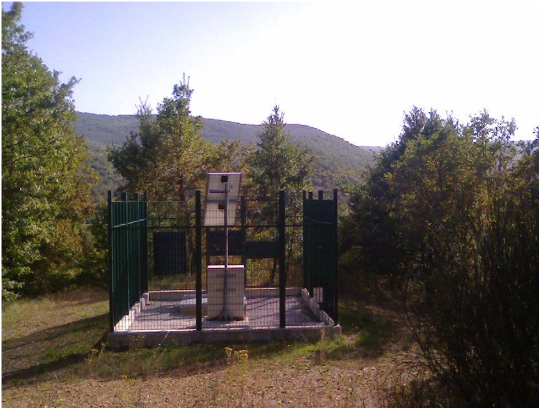
Fig. 23: esempio di stazione sismica completamente autonoma in zone remote.
