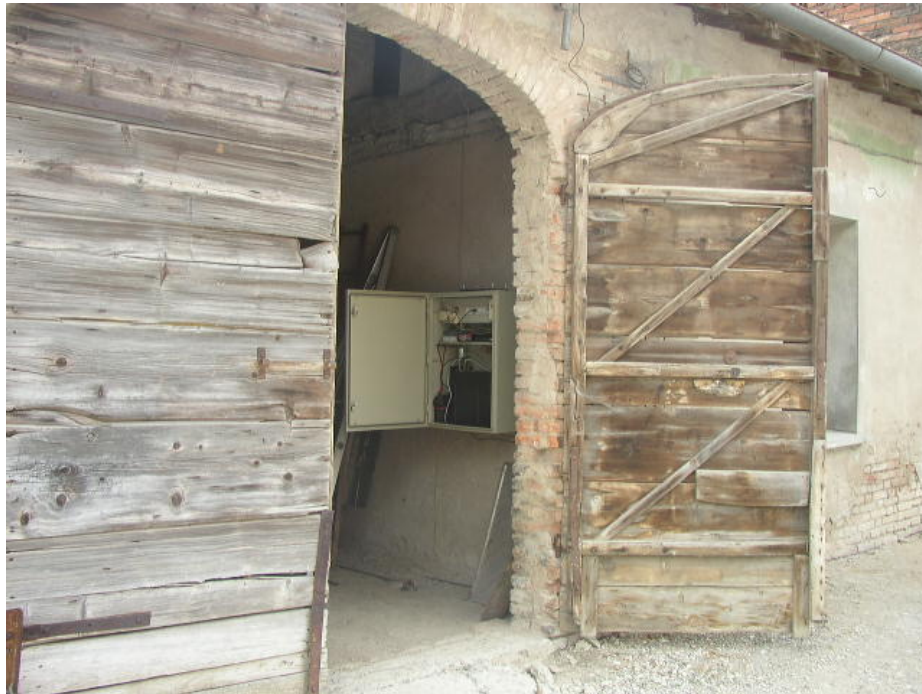
Fig. 25: armadietto con la strumentazione installato all'interno di deposito per attrezzi agricoli.
