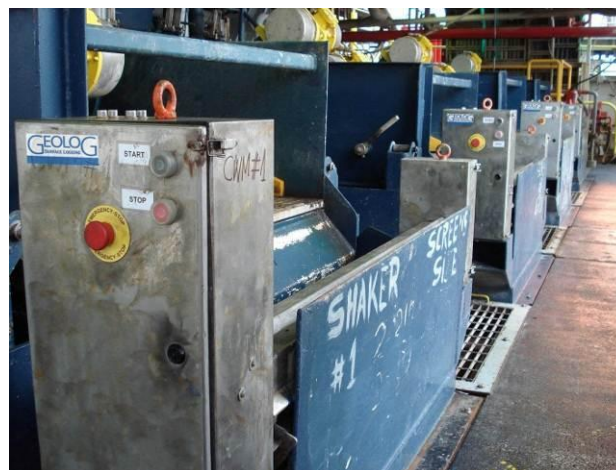
Figura 3.19: Installazione di un Sistema di CVM composto da quattro macchine
