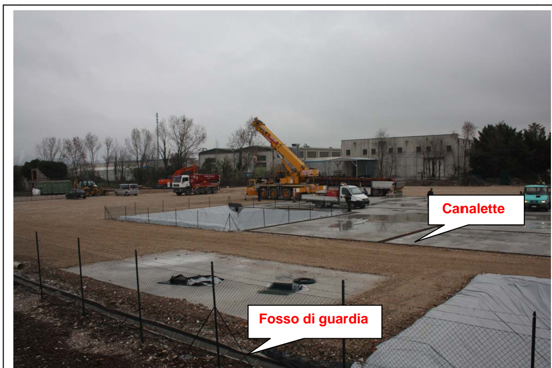
Figura 5.15. Solette in cemento armato e canalette di drenaggio. (Area pozzo Sant’Andrea 1 dir ST – Apennine Energy S.p.A.).
