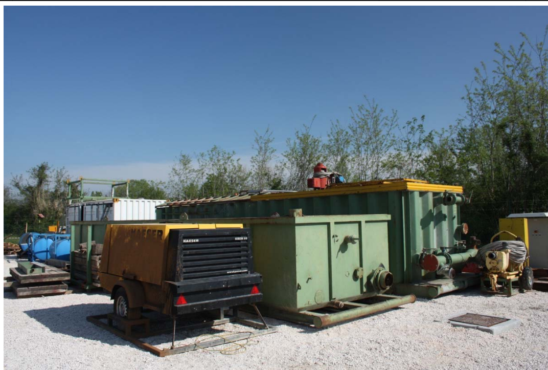
Figura 5.16 Vasca acque industriali (Area pozzo Cascina Daga 1 dir – Apennine Energy S.p.A.);
