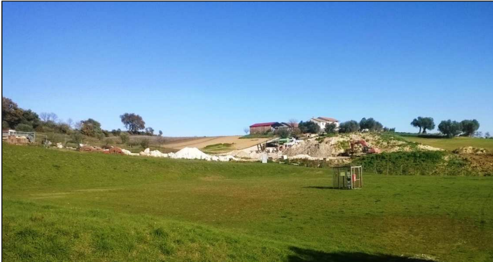
Figura 51: Deposito di materiali da costruzione/inerti e terreni vari confinante a NE con il pozzo SMN 3.
