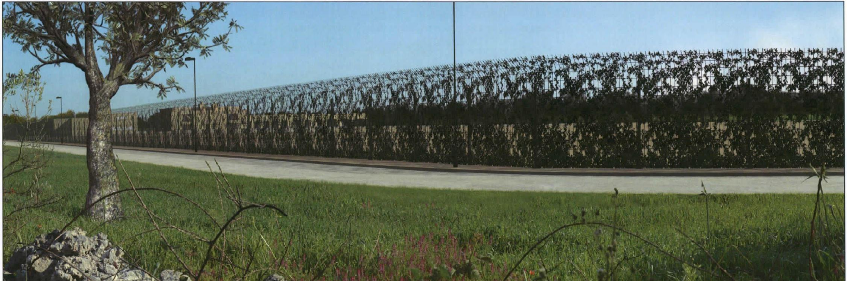
Fig 1/ D - Met. Interconnessione TAP, DN 1400 (56"), DP 75 bar. Impianto n.1 in Comune di Melendugno
