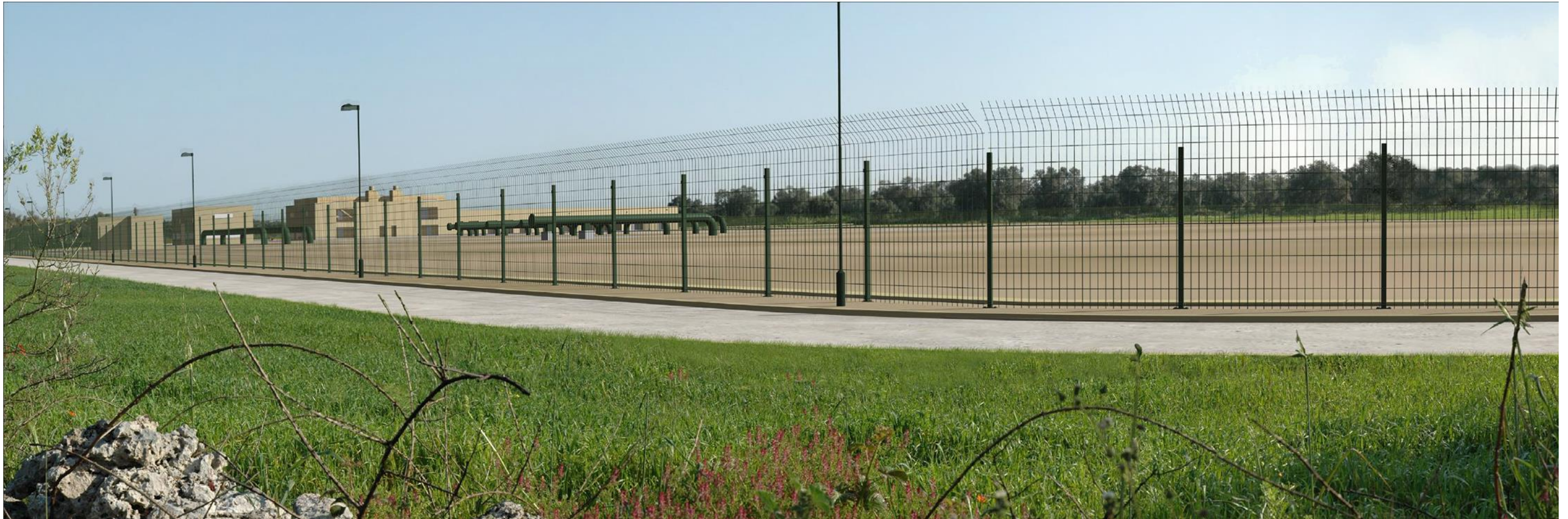
Fig 1/ B - Met. Interconnessione TAP, DN 1400 (56"), DP 75 bar. Impianto n.1 in Comune di Melendugno
