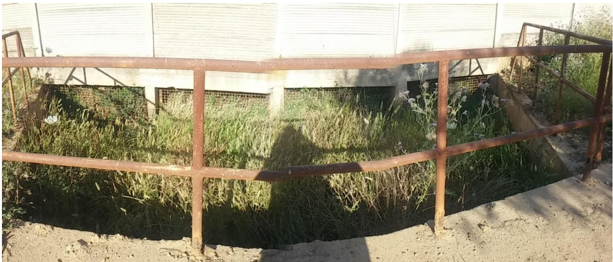
Figura 44 – Attraversamento fluviale, in località Nuraghe Liberno, alla base della recinzione dello Stabilimento Sarlux a circa 200 metri a ovest dall'area di progetto (Figura 45)
