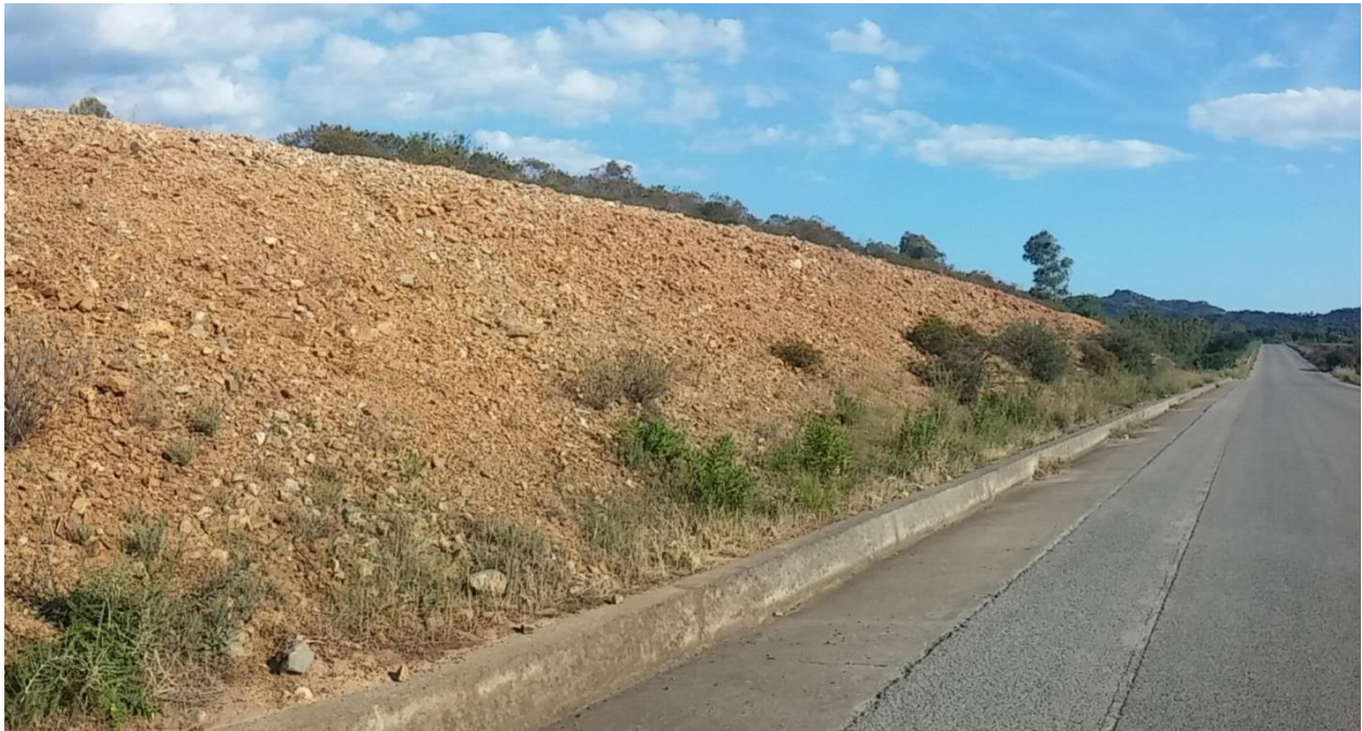
Figura 12 – Depositi alluvionali di “glacis” nei tagli stradali della strada che costeggia esternamente lo Stabilimento Sarlux, a ovest dell’area di progetto
