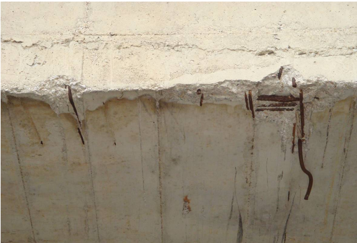
Foto 4 – Vista intradosso – armature scoperte
