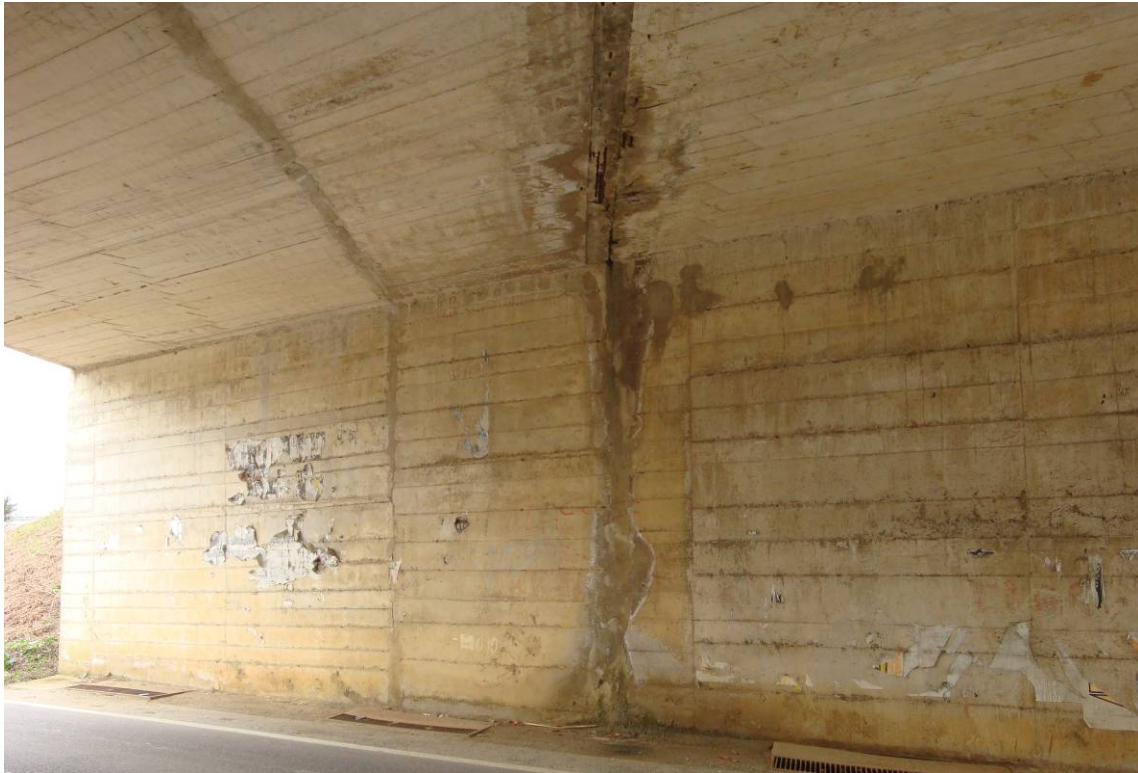
Foto 3 – Vista intradosso – infiltrazioni dal giunto
