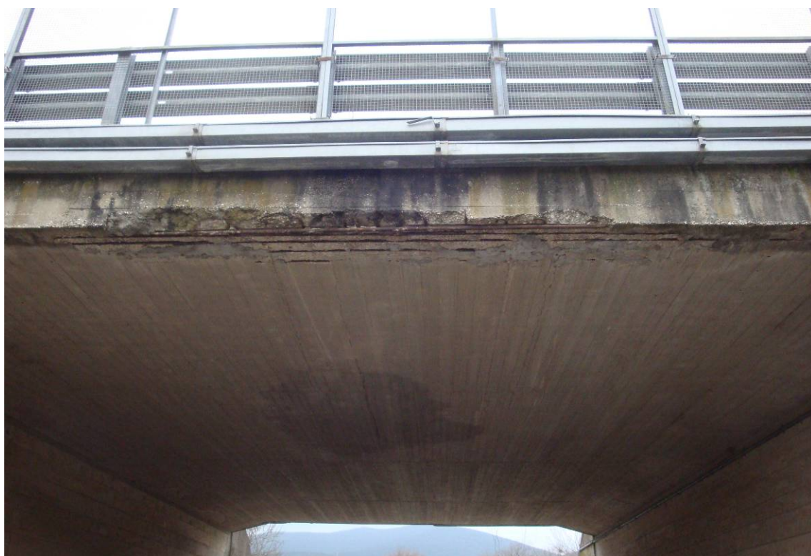
Foto 3 – Vista intradosso – armature scoperte
