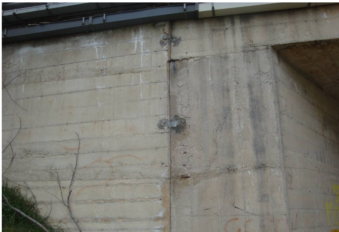
Foto 4 – Particolare del giunto tra muro frontale e muro andatore strumentato con una biffa in vetro
