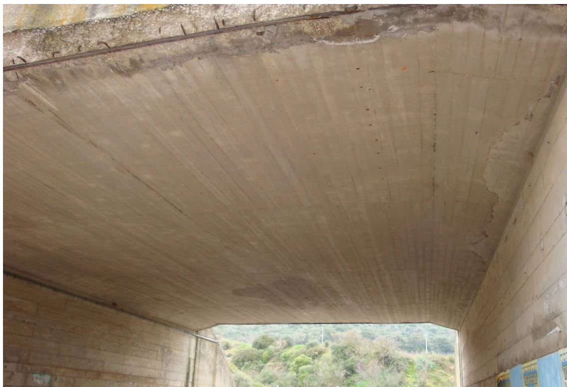
Foto 4 – Vista intradosso – armature scoperte
