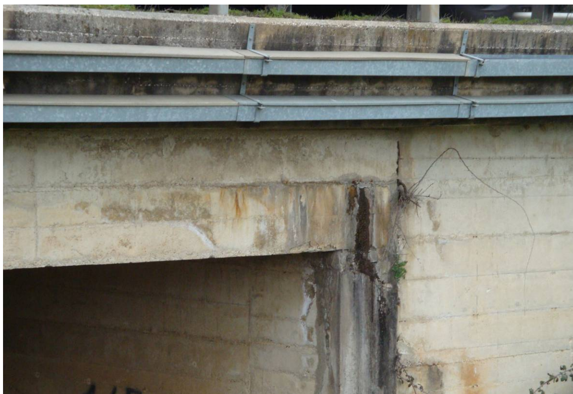
Foto 8 – Sottovia scatolare lato nord – degrado cls.
