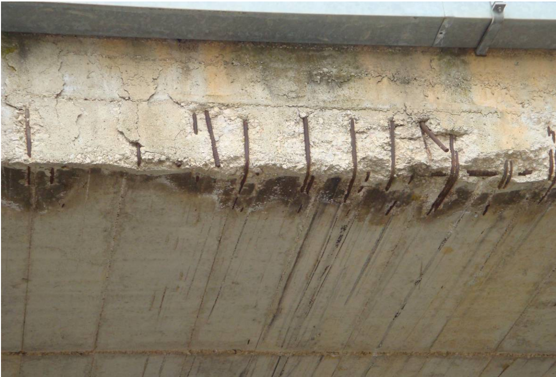
Foto 3 – Vista intradosso – armature scoperte
