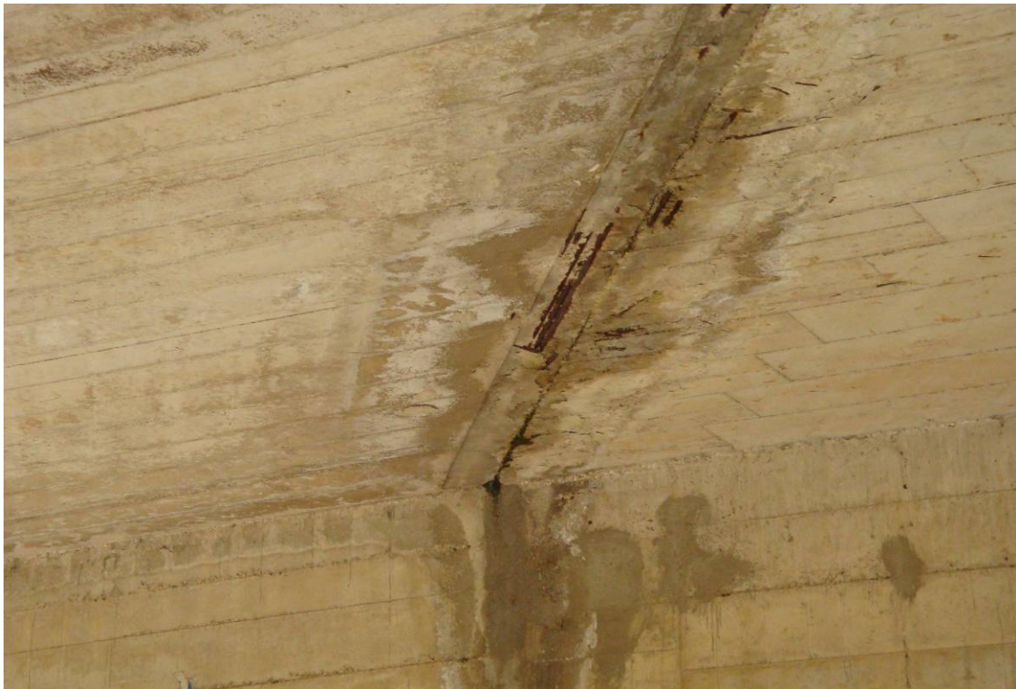
Foto 4 – Vista intradosso – armature scoperte lungo il giunto
