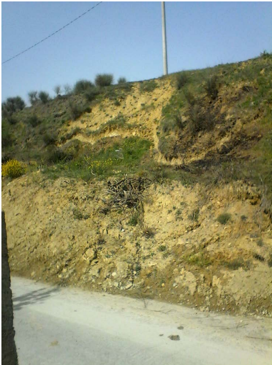
Foto 8 – frana di tipo scorrimento rototraslazionale
