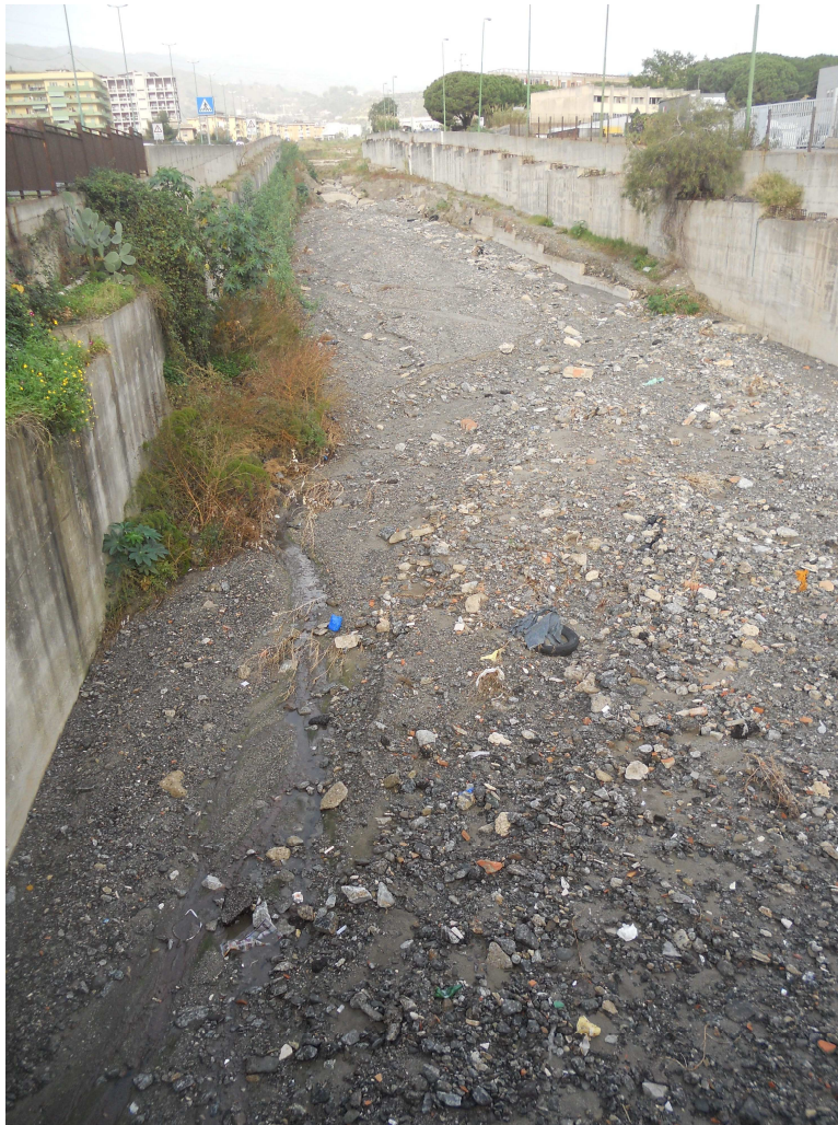
Foto 8: Alveo regimentato della Fiumara di San Filippo nel tratto che attraversa la città di Messina
