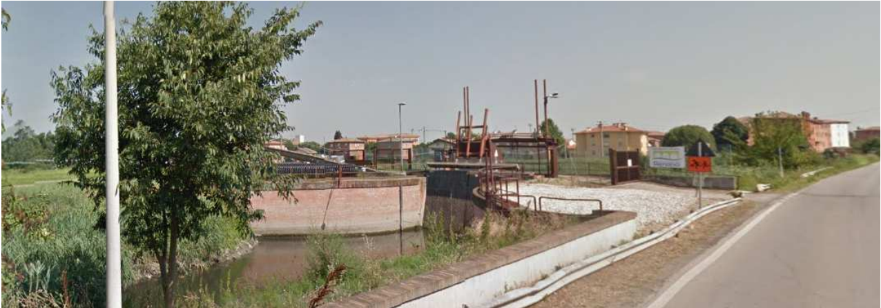
Figura 34: Paratoie sul canale Navile necessarie per deviare al portata sul Canale Diversivo
