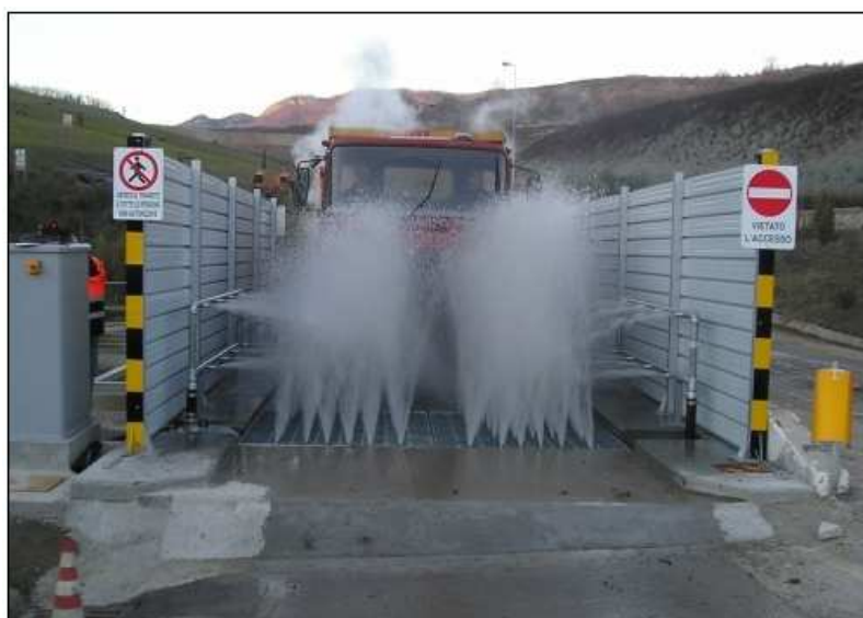
Figura 5 - Impianto lavaggio ruote
