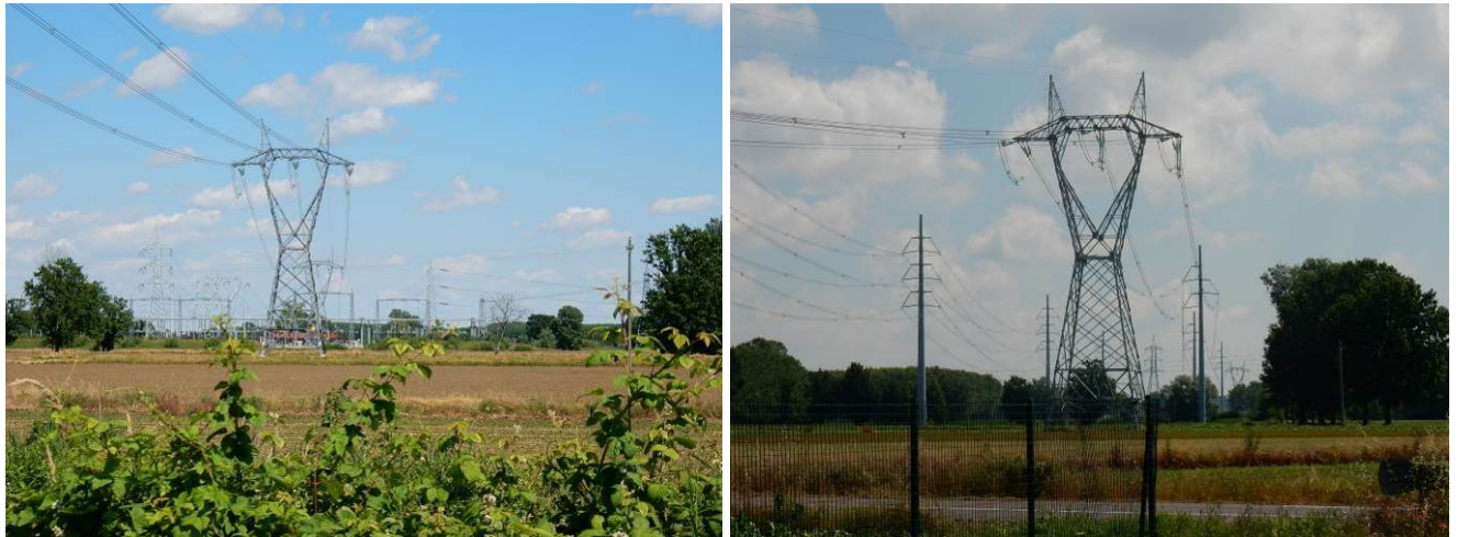
Figura 4.5. Stazione elettrica di Chignolo Po (a sin) linea aerea Chignolo Po – Maleo e Chignolo Po – San Rocco Po (a dx)
