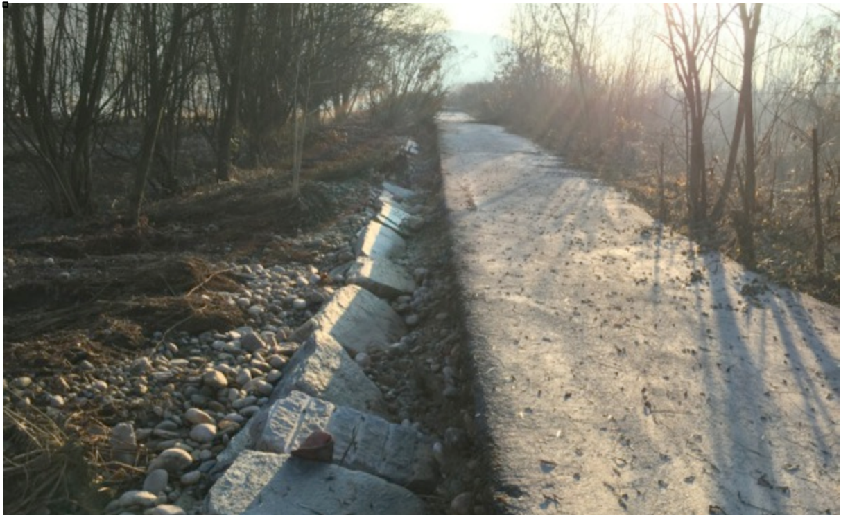
Danni alla scogliera di protezione della pista ciclabile in sponda sinistra a monte della traversa
