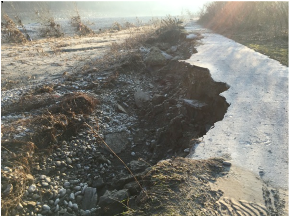
Danni alla pista ciclabile in sponda sinistra a monte della traversa
