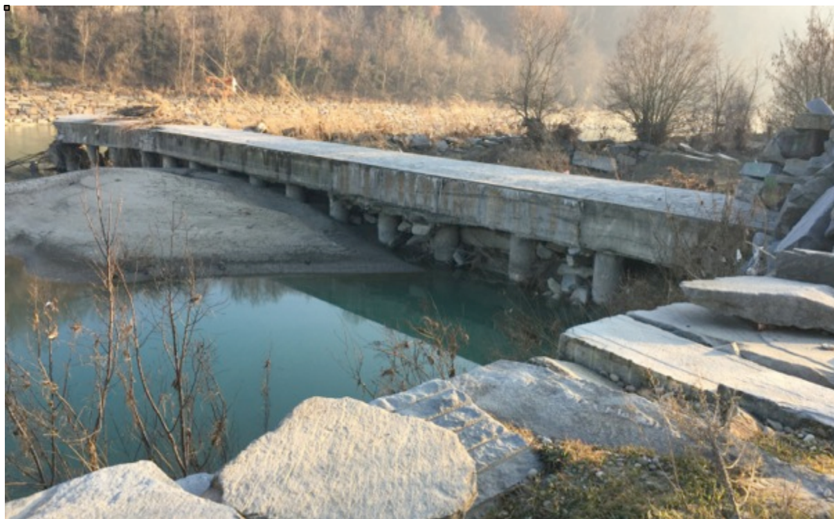
Il rudere della traversa abbattuta dalla piena del 2010
