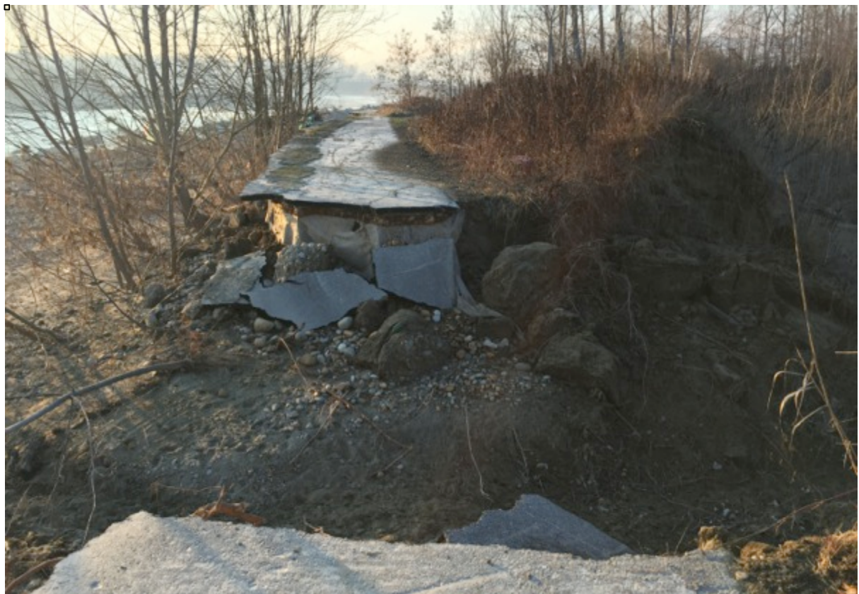
Danni alla pista ciclabile in sponda sinistra a monte della traversa
