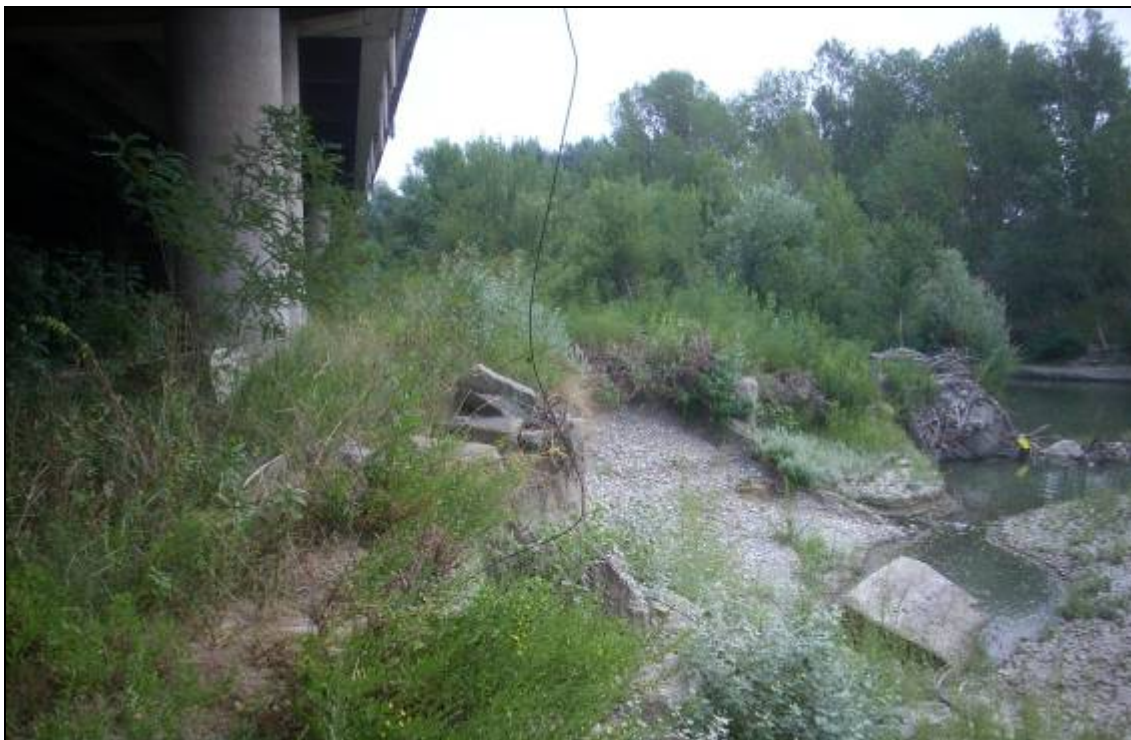
Fig.33- Alveo attuale del F. Reno: particolare dei fenomeni erosivi molto attivi sulle scarpate e prossimi alle fondazioni dell'impalcato della tangenziale.
