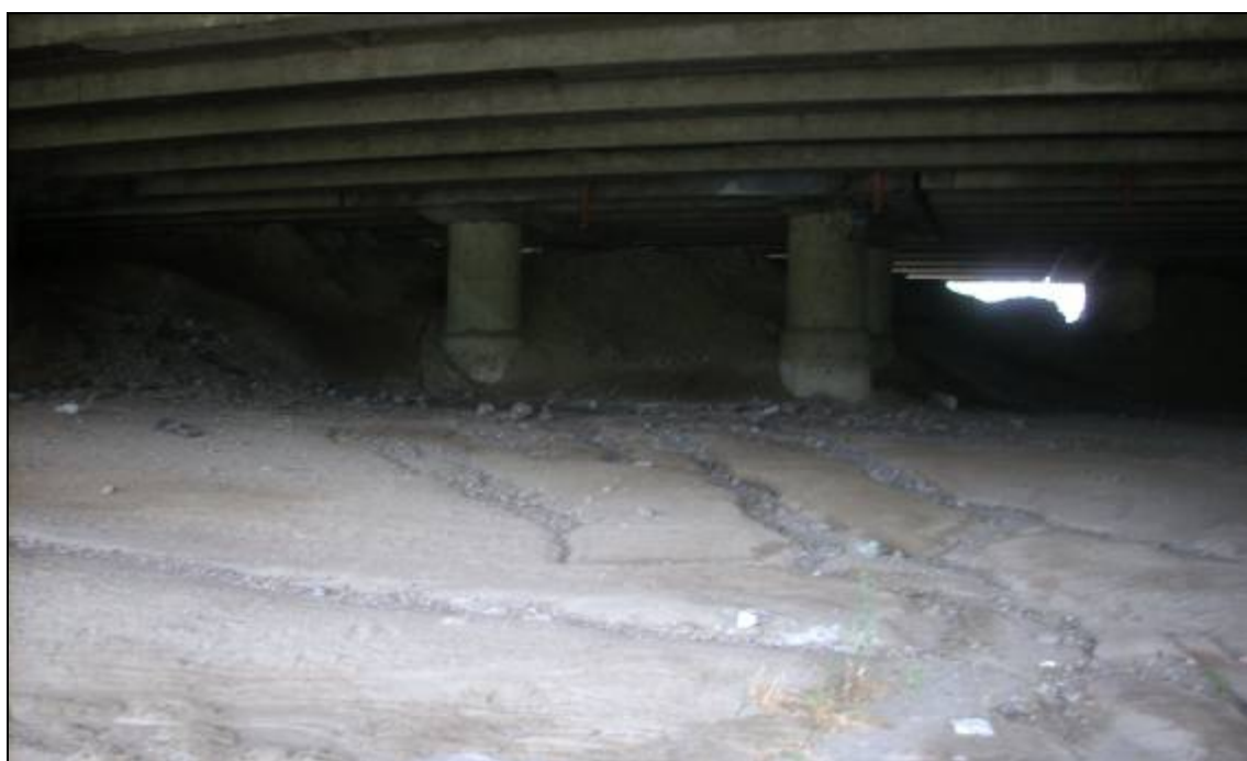
Fig.36 - Alveo attuale del F. Reno: erosioni superficiali attive legate al ruscellamento concentrato; l'acqua proviene dal sistema tangenziale in esercizio; in secondo piano s'intravede il profilo dell'argine idraulico destro.
