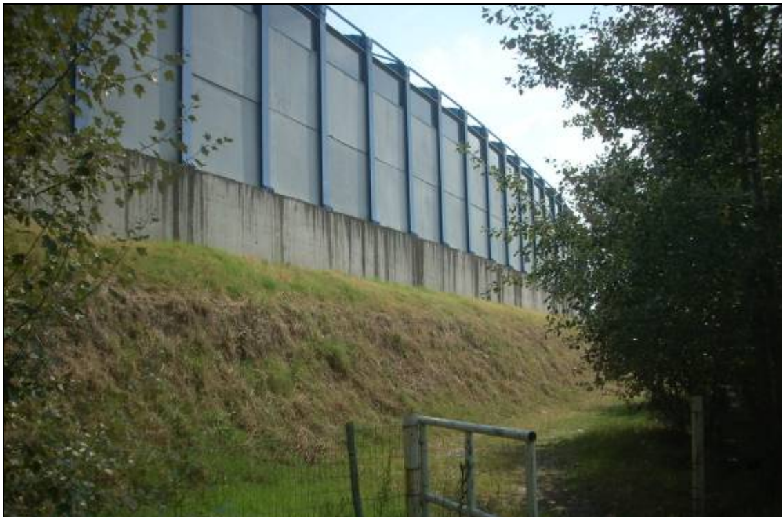
Fig.45 – Rilevato artificiale, in via del Saliceto con altezza media da 2+3 m circa con funzione portante del muro di contenimento del sistema tangenziale in esercizio.
