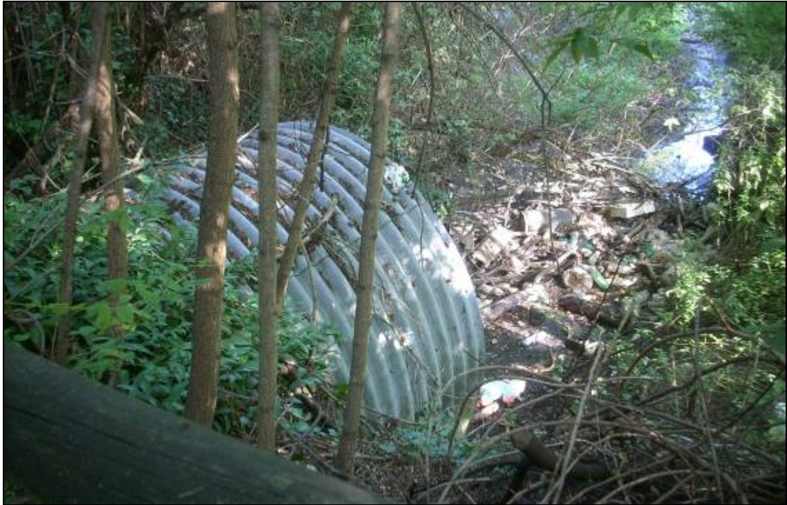
Fig. 41 - Alveo Savena Abbandonato, si noti il tubo corrugato con un diametro di 1.5m per l'attraversamento.
