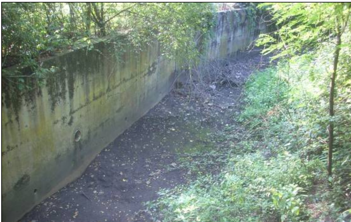
Fig. 39 - Alveo attuale del Savena Abbandonato, si noti la risagomatura artificiale delle sponde.
