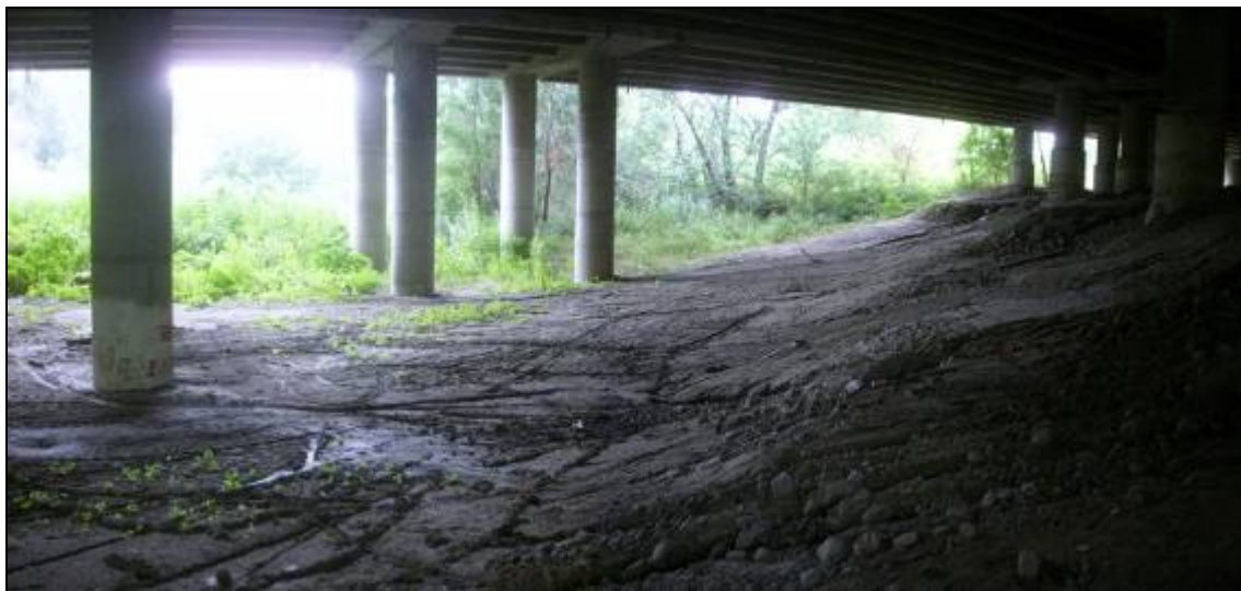
Fig.35 - Alveo attuale del F. Reno: erosioni superficiali attive legate al ruscellamento concentrato; l'acqua proviene dalle banchine del sistema tangenziale in esercizio; a destra della foto si vede il profilo dell'argine idraulico sinistro.
