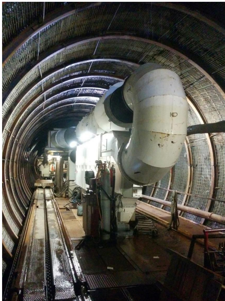
Figura 5.3 – I sostegni messi in posto dalla Pk 4+200 (centine + barre metalliche in calotta + rete metallica alle reni e ai piedritti)
