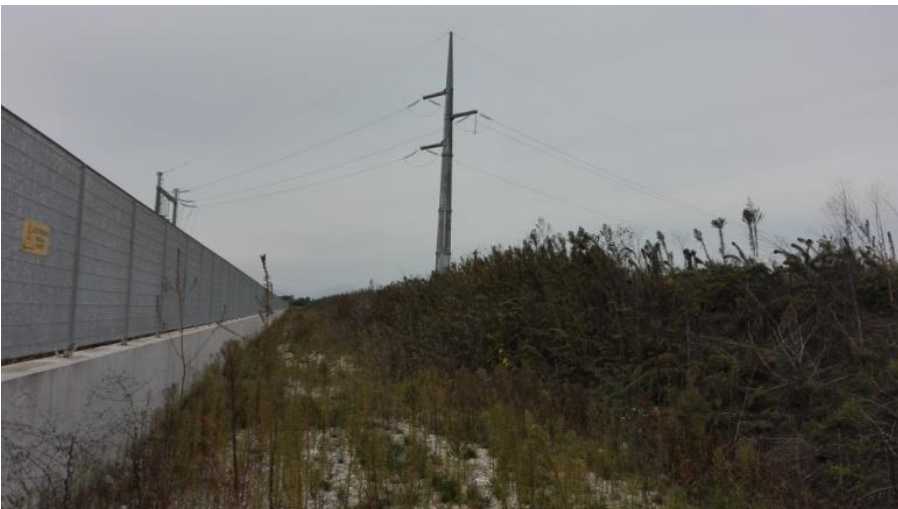
Foto 5.6 - Recinzione perimetrale pista in ghiaio e rilevato con infestanti
