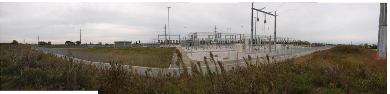
Foto 5.5 - Panoramica Nuova Stazione Elettrica
