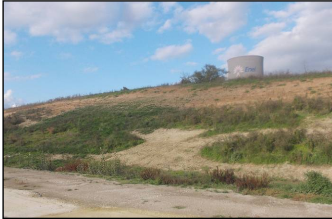
FIGURA 30 - SCARPATA REALIZZATA PER SCAVO IN TERRENO IN POSTO
