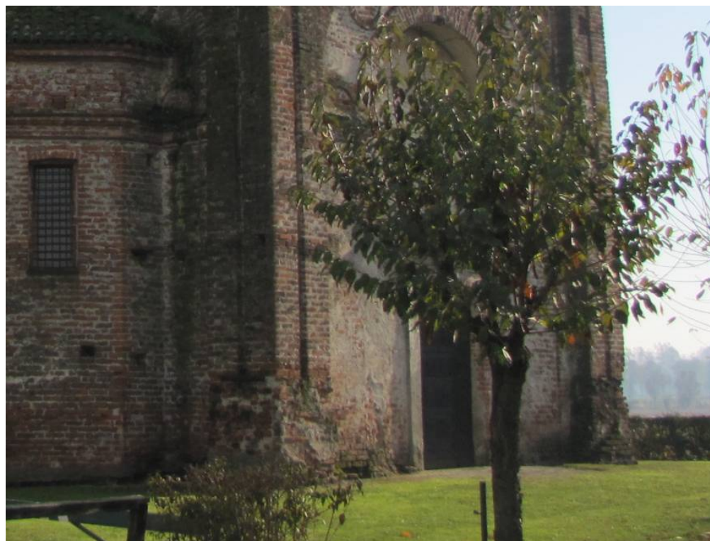
Figura 3.7 – Particolari dei muri perimetrali esterni sul lato della facciata principale, su cui si notano alcuni interventi passati di restauro e situazioni di alterazione Rilievo del 05/12/2013. (Codice Foto: 4249)
