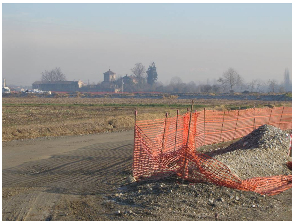
Figura 3.17 – La visuale dell'Oratorio dalla strada poderale proveniente da Sud-Ovest. Sulla destra i lavori del cavalcavia di sovrappasso dell'asse principale autostradale. (Codice Foto: 4208)
